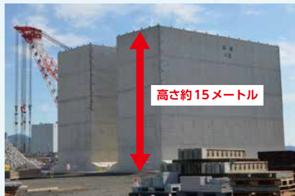
▲白くて大きな物体の正体 耐震強化岸壁の本体部分=ケーソン
