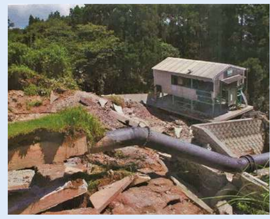
▲決壊した吉野山排水ポンプ施設の様子
