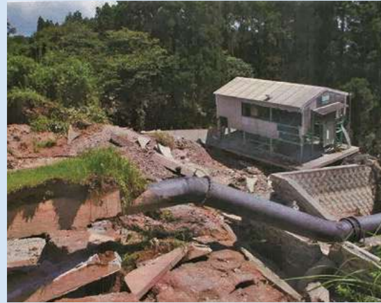
▲決壊した吉野山排水ポンプ施設の様子
