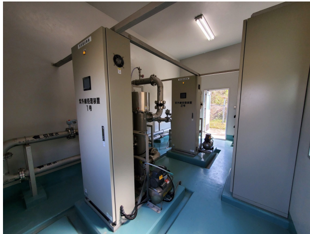
紫外線処理設備の様子
