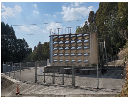
耐震性配水池、SUS製、緊急遮断弁設置済み
