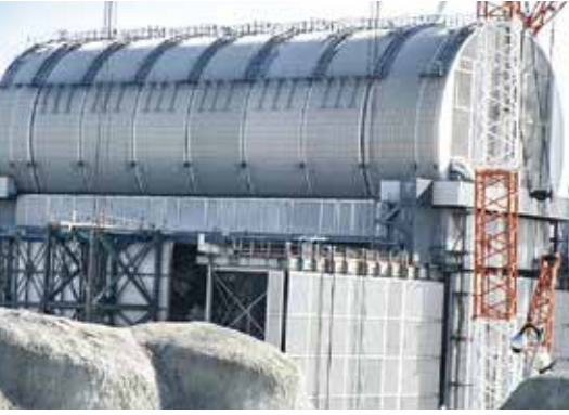
◀ 燃料取り出しのためのドーム屋根が設置された3号機原子炉建屋
