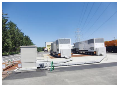
移動式大容量発電機(ケーブルを恒設化し、中央制御室からの遠隔起動が可能)
