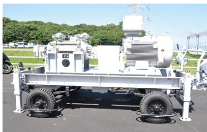
可搬型電動低圧注入ポンプ
