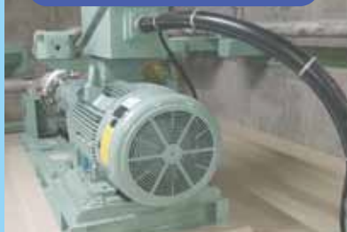
常設電動注入ポンプ1台
