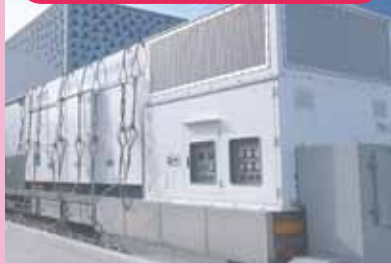
固定式発電機 (4,000kVA) 2台
