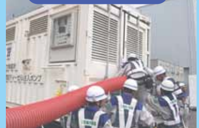
冷却水の供給訓練
