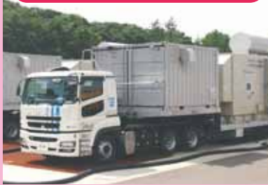
可搬式発電機(1,825kVA)2台
