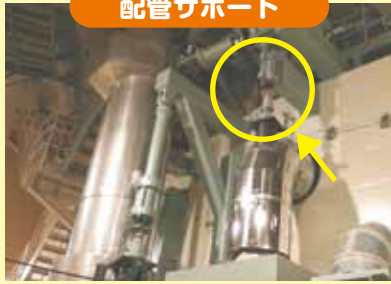
配管サポート
