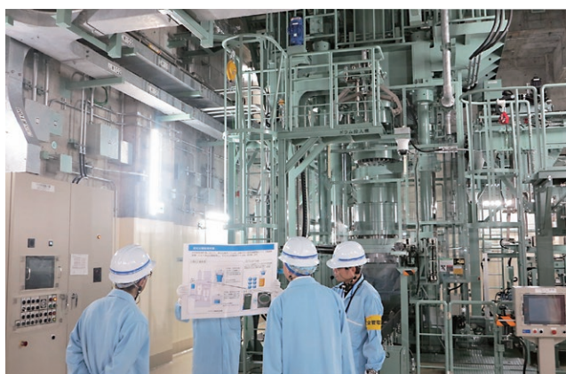
【高圧圧縮処理室】
