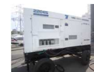
可搬型直流電源設備
