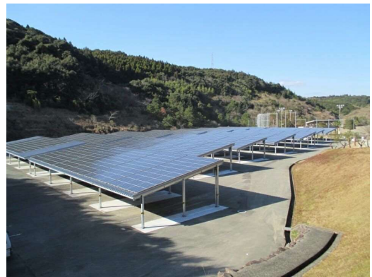
総合運動公園太陽光発電設備
