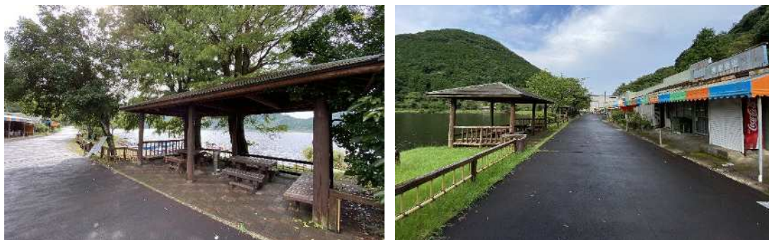
写真 2-24 老朽化している東屋（休憩所）
