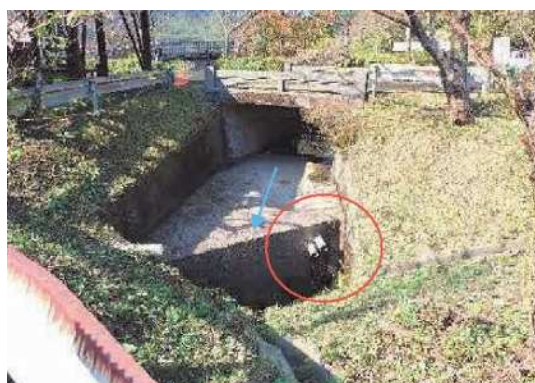
現状の越流式余水吐き（蘭牟田池）
