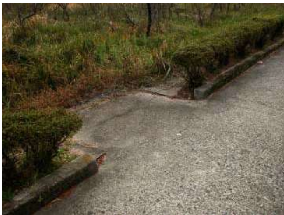
写真 7 大きな切り欠き (B 地区)
