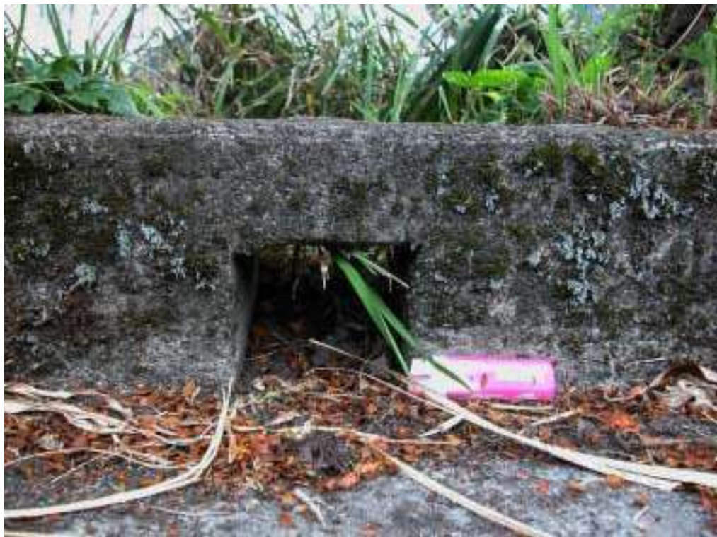
写真 6 幅約 11cm×高さ約 9cm の四角形の穴 (B 地区)
