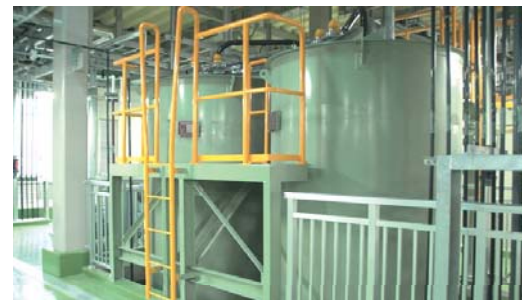
活性炭吸着塔
