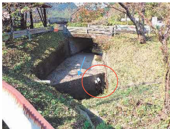
機能していない排水パイプ（撮影日：R4.11.9,水位 94 cm）
