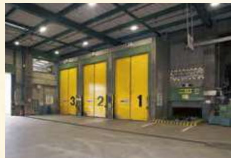
1 プラットホーム 施設へ運びこまれたごみを、投入扉または、ダンプボックスを通してごみピットに投入します。
