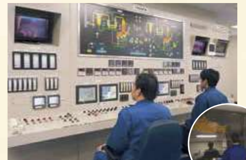
6 中央制御室 施設の運転はここで全て集中的に管理します。また、ごみクレーンの運転もここで遠隔操作します。
