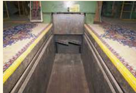
② 切断式破砕機 搬入された粗大ごみを切断します。
