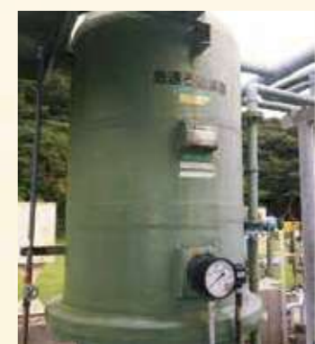
② 急速ろ過装置
