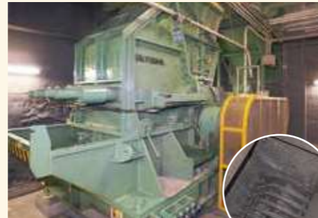
④ 回転式破砕機 供給された不燃性粗大ごみは高速回転するハンマーで叩いて細かく破砕され、破砕物の選別・搬送の安定化を図ります。
