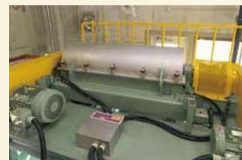
① 汚泥脱水機
