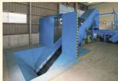
① 搬送コンベヤ
