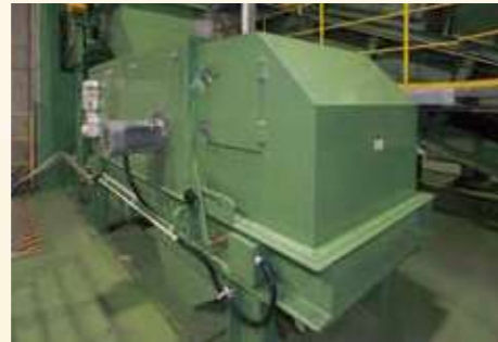
③ アルミ選別機 粒度選別機で分けられたアルミ可燃混合物から渦電流と磁界の相互作用によりアルミを分離回収します。
