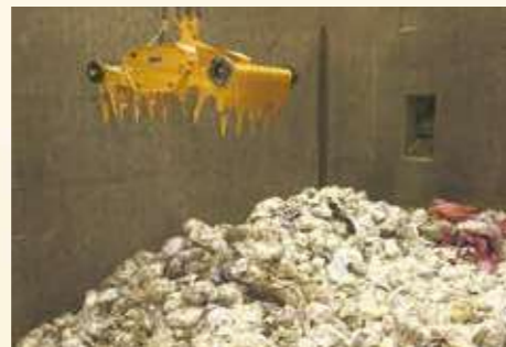
2 ごみピット・ごみクレーン ごみピットに溜められたごみをごみクレーンで攪拌した後、ごみ投入ホッパへ投入します。
