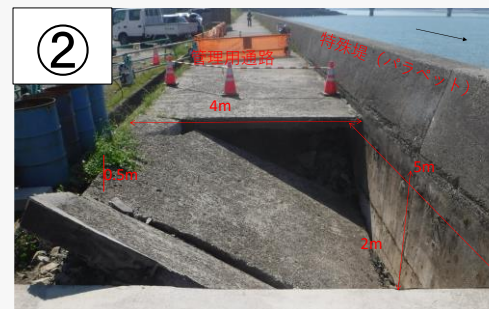
H29.5.19被災状況 (船間島地区)
