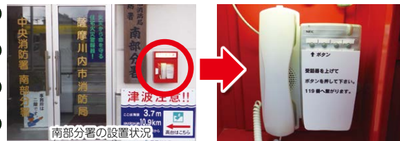
南部分署の設置状況
