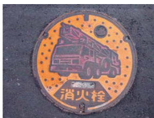
車道に設置されている消火栓
