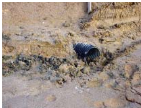
ボルゲート管を利用した田面排水口
