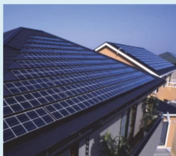
太陽光発電設備
