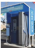
電気自動車充電設備
