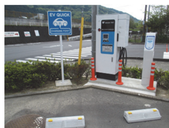
市役所本庁舎に設置した電気自動車用急速充電器
