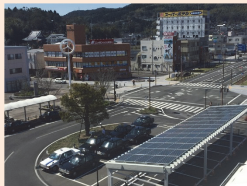
川内駅西口駅前広場に導入された太陽光発電・小型風力発電・蓄電池
