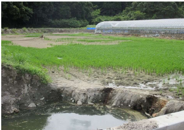
耕地被災状況
