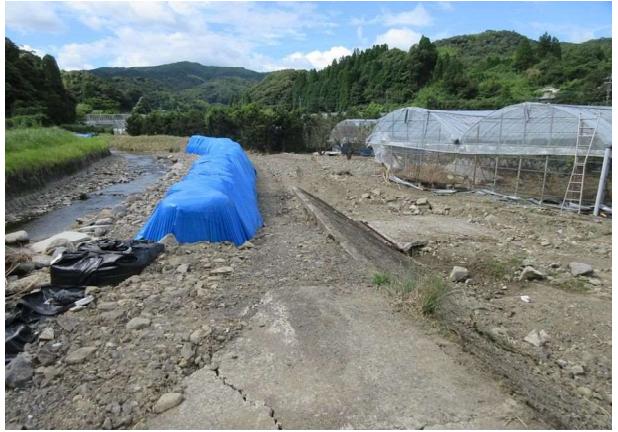
山田川被災状況（下流側から）
