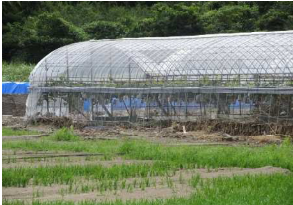
ハウス被災状況
