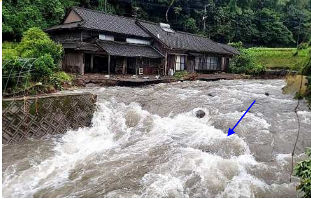
県河川葛川の護岸決壊（令和7年8月8日）
