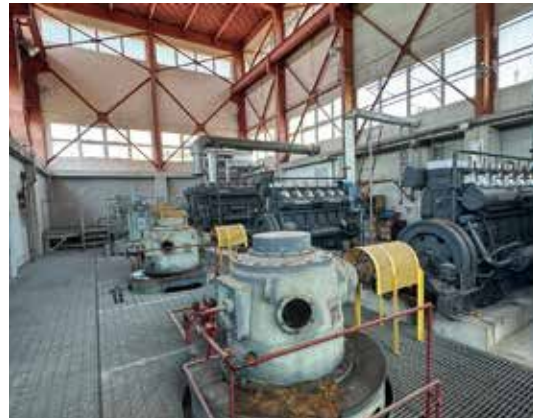
向田ポンプ場（ポンプ設備）
