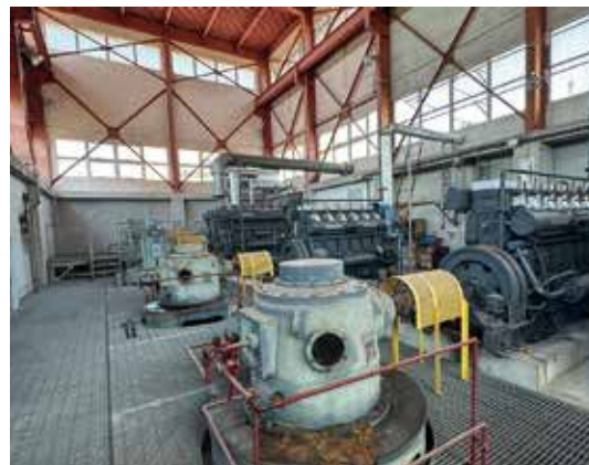
向田ポンプ場（ポンプ設備）
