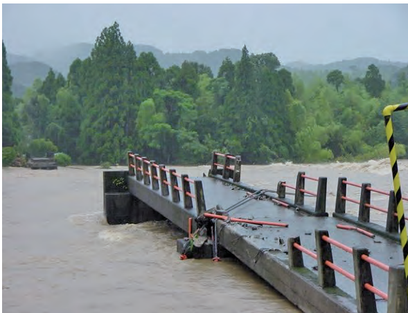
久住橋流出の状況（H18年7月豪雨）
