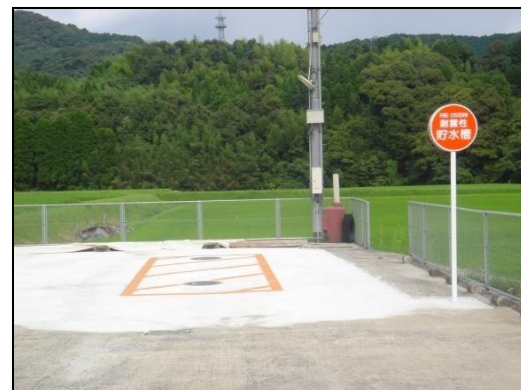
耐震性貯水槽40トン
