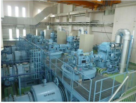
排水ポンプ施設〈平佐ポンプ場〉(平佐町)
