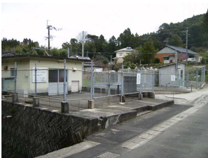
高江簡易水道水源地
