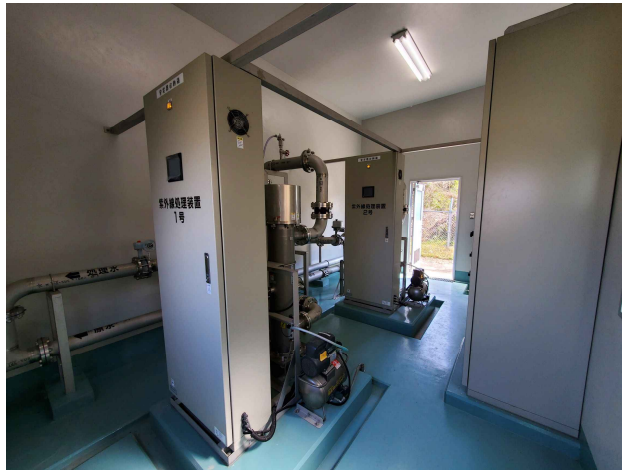
紫外線処理設備の様子
