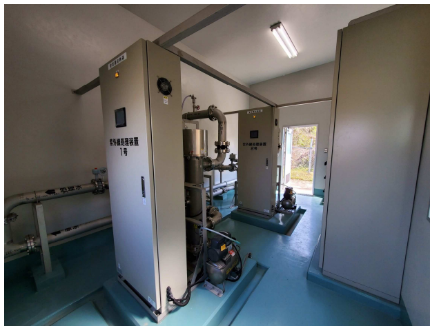
紫外線処理設備の様子
