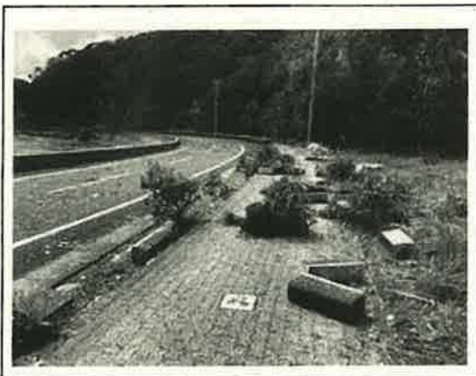
上甌町平良 道路側溝状況
