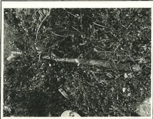
防犯灯柱倒壊
