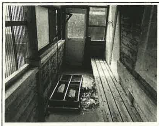
桑之浦バス停待合所ガラス破損
