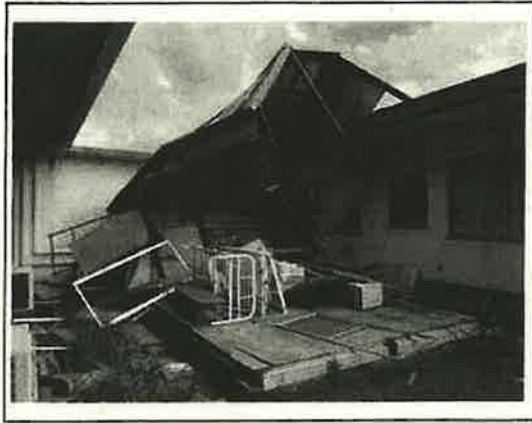
上甌診療所敷地内プレハブ倉庫大破
