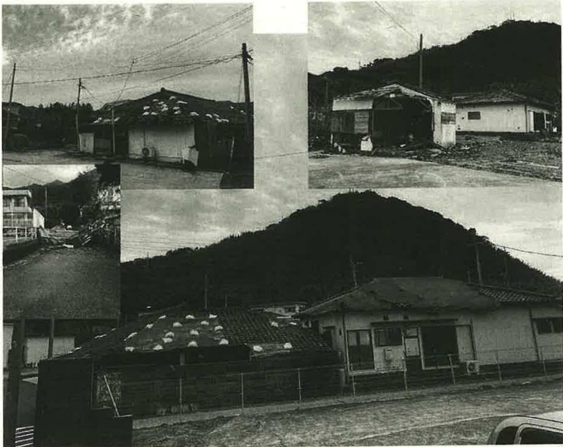
【建物被害・青瀬ノ瀬尾地区】
