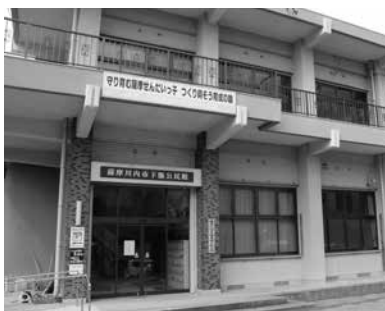
耐震性が低いため現在使用ができない下甌公民館
