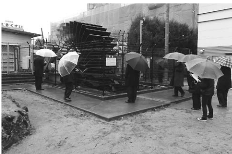
小水力発電所（都留市）
