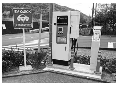
電気自動車用の急速充電器(市役所本庁)
