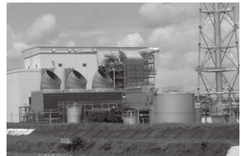
現在建設中の木質バイオマス発電施設 (中越パルプ工業川内工場)
