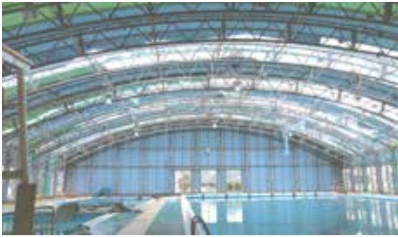
損傷した里プール
