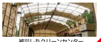
被災したクリーンセンター
