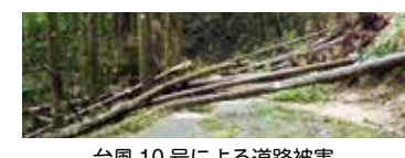
台風10号による道路被害
