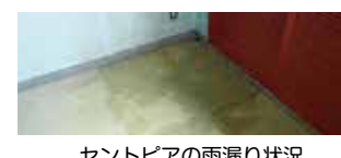
セントピアの雨漏り状況
