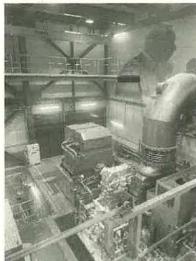
発電タービン部分
