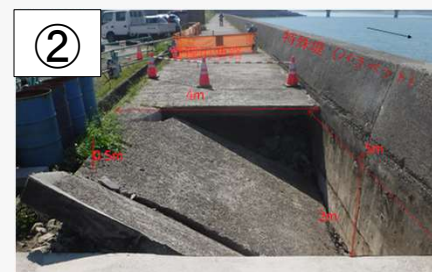
H29.5.19被災状況 (船間島地区)
