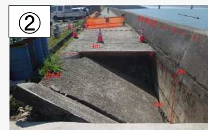
H29. 5. 19被災状況 (船間島地区)
