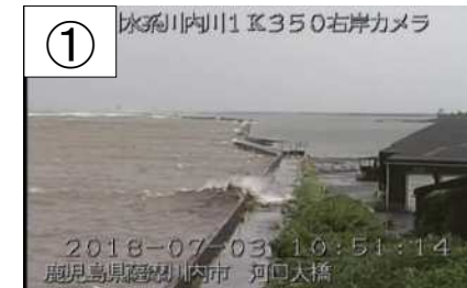
H30. 7. 3台風7号時 高潮による 越波状況 (船間島地区)
