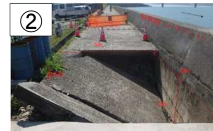
H29. 5. 19被災状況 (船間島地区)
