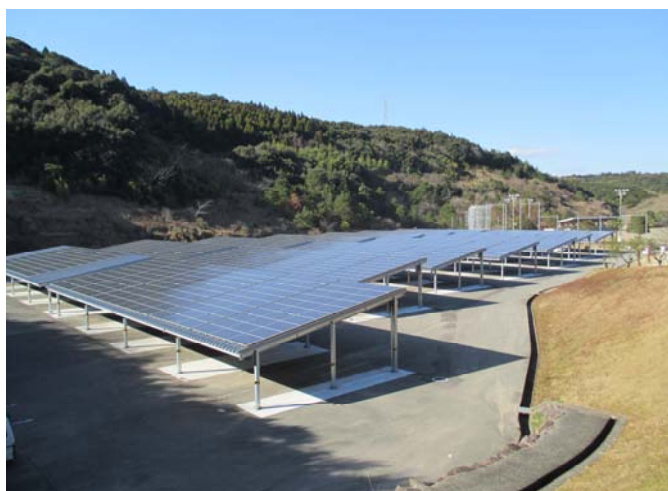
薩摩川内市総合運動公園太陽光発電所
