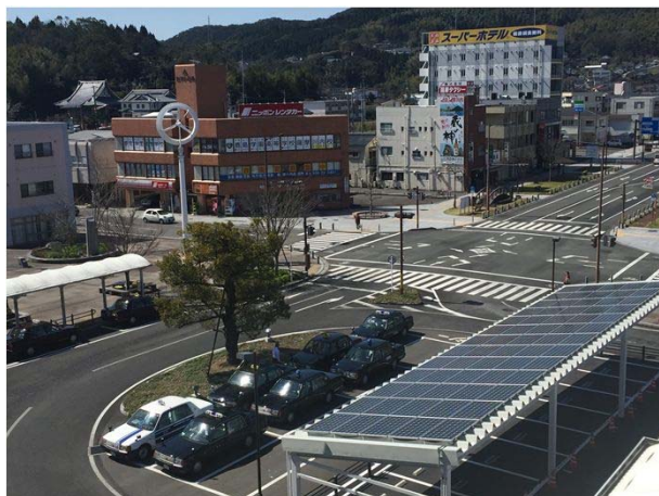
川内駅次世代エネルギー発電設備 (川内駅西口駅前広場)
