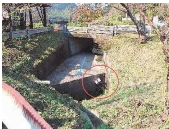
機能していない排水パイプ (撮影日：R4.11.09、水位 94 cm)
