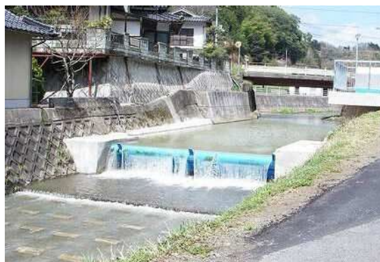
水位調整施設（転倒堰）の事例
