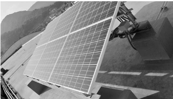
中学校に設置の太陽光発電設備
