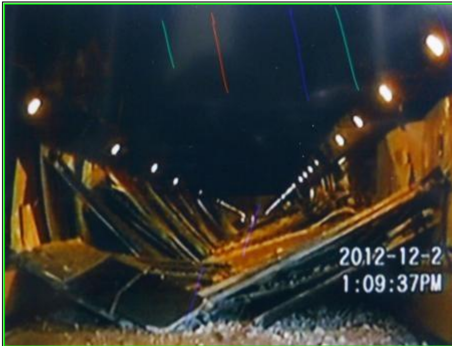
笹子トンネルの事故状況：山梨県警報道提供資料
